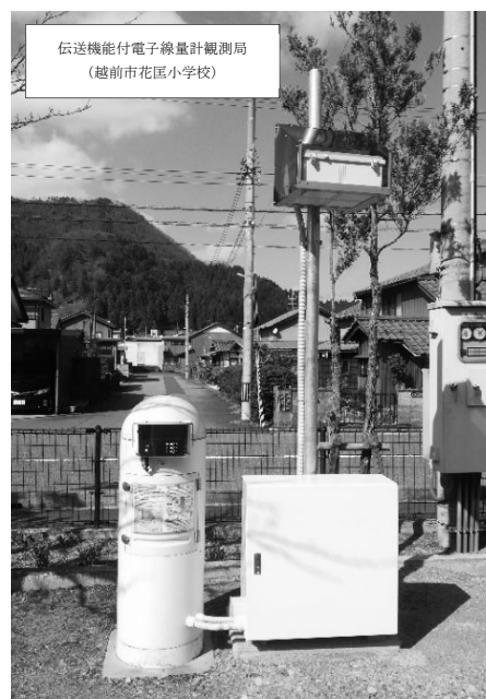
左：本体 右上：衛星アンテナ収容BOX 右下：バッテリーBOX
