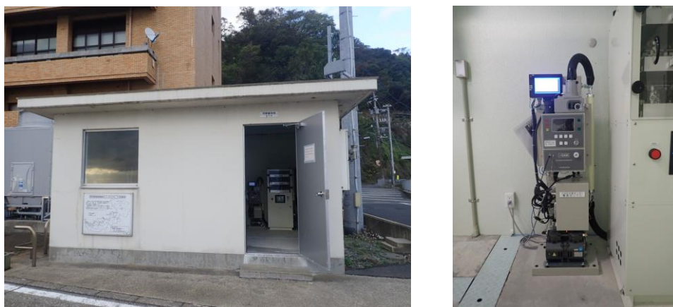
図-4 大気モニタ設置状況（既設モニタリングポスト内設置）
