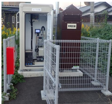
図-5 大気モニタ設置状況（単独設置）
